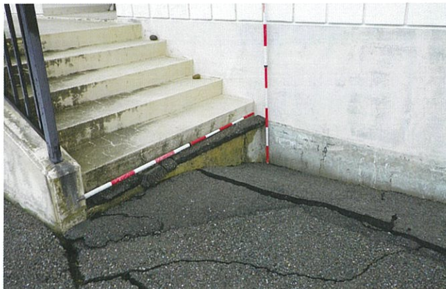
農業集落排水処理施設周りの陥没状況
