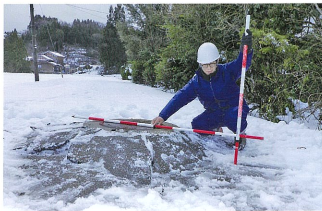
マンホールの隆起状況
