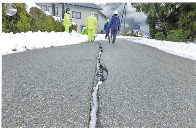
管路埋設道路の亀裂
