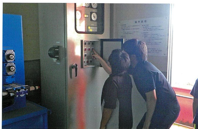
日高村立石取水操作室にて操作説明する 水土里ネット土佐 一森 主事
